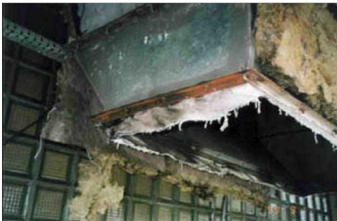
Rys.9. Płótno azbestowe w przewodach wentylacyjnych [ 5]
