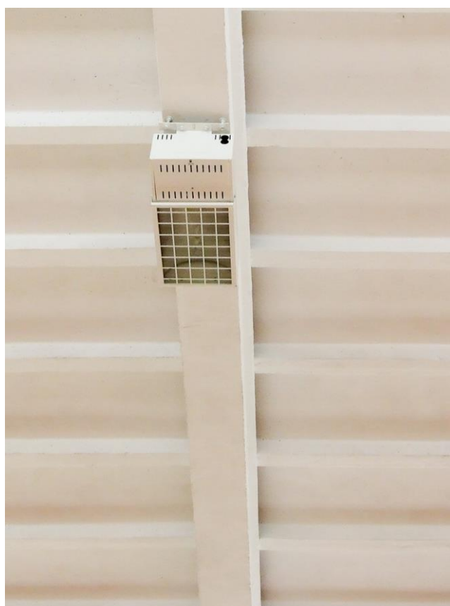
Rys. 8 Oprawa na sali gimnastycznej
