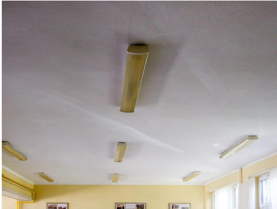
Rys. 1 Przykład starych i zabrudzonych opraw
